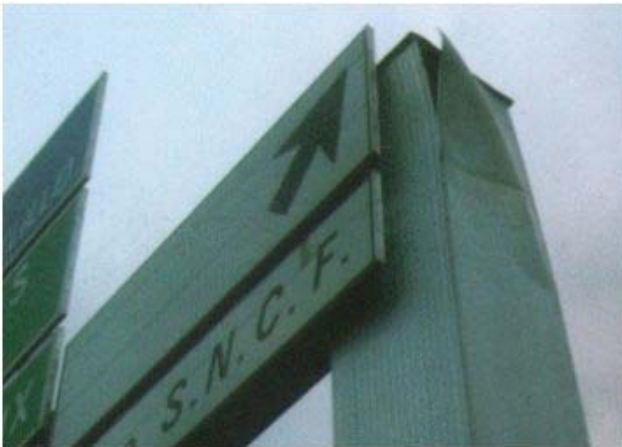
Tempête de janvier 1998 ( Photo J. Berthelémy )
