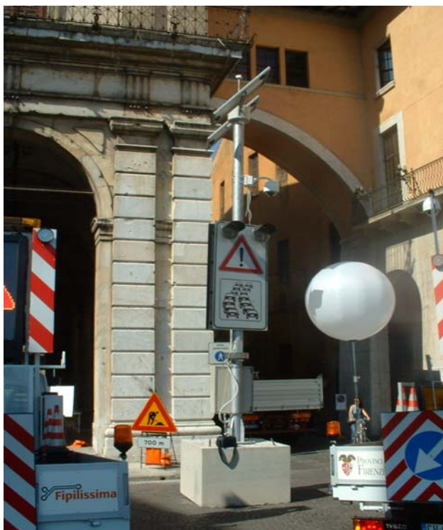
“Figure 4 – Signalisation de la présence d'un ralentissement, activable à distance”
