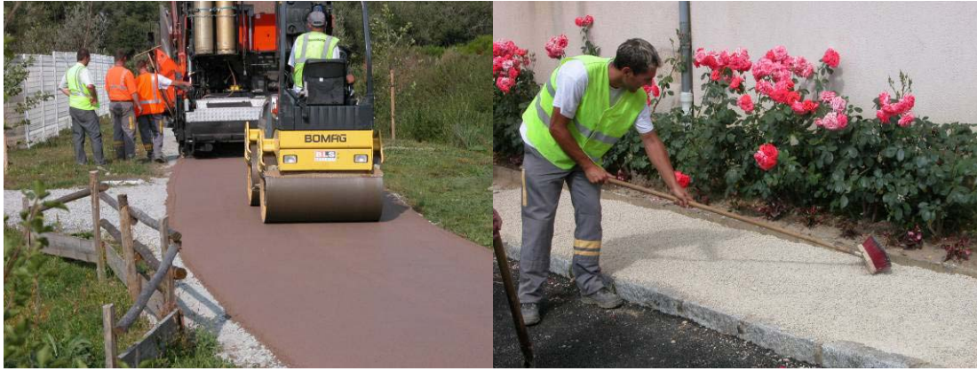
Photographies 13 et 14 - Mise en œuvre d'enrobés à froid fabriqués avec de l'émulsion de liant végétal.
