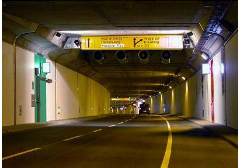
Figure 12 - Équipement de sécurité dans le tunnel du « Tiergarten » de Berlin
