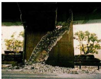
( a ) Dégâts sur une pile, Séisme du Sud du département de Hyôgo (1995)
