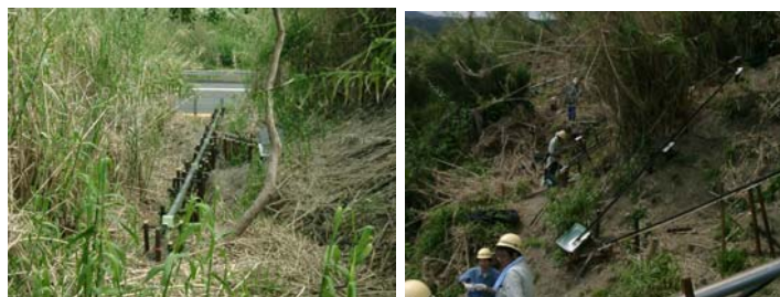
Photo 2 - Exemple d'installation de capteurs mesurant le glissement d'une pente
