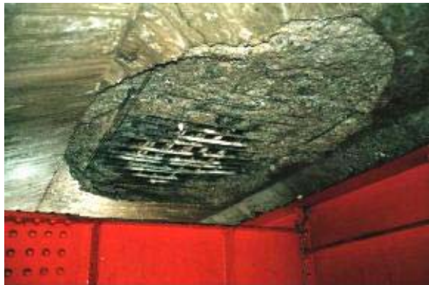
Photo 2 – Ecaillage des dalles en béton RC
