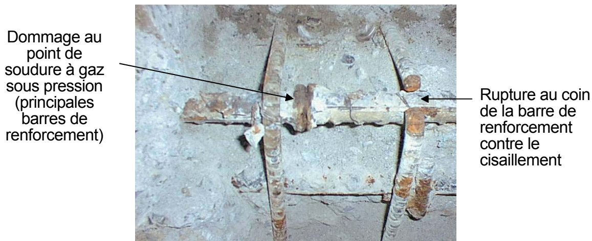
Photo 4 – Rupture des barres de renforcement par réaction alcali-agrégat
