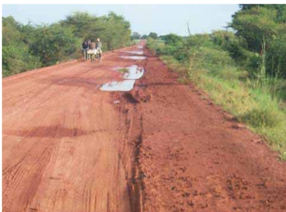
Figure 11 - Exemple d'ornières et d'affaissements. (Source: Mahamadou OUEDRAGO, Burkina Faso)
