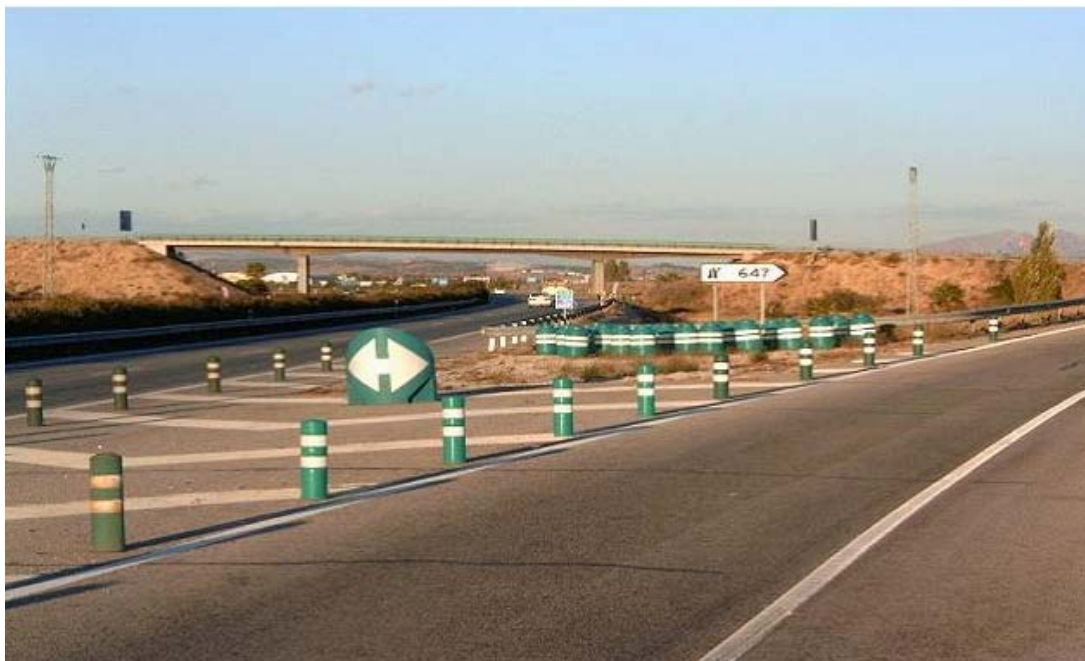
Figura 3- Ejemplo de actuación de bajo coste en mejora de balizamiento en Murcia
