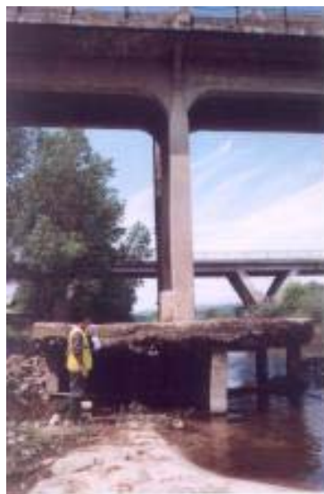
Figura 6 – Socavación con socavación profunda
